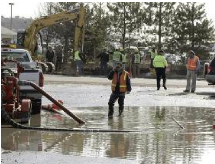
2006년 첼시 이스턴에비뉴의 한 수도관이 파손되는 사고가 있었다
