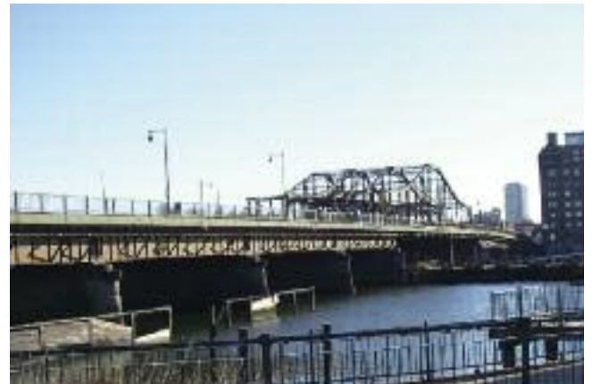
117년이 된 찰스타운 브릿지가 긴급 보수 공사를 위해 임시 통행이 중단되었다
