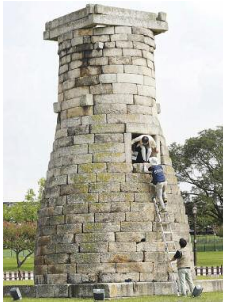
13일 국립문화재연구소 문화재 조사원들이 13일 경북 경주시 첨성대에서 강진에 따른 피해 조사를 하고 있다. 신라시대 지진설계를 한 선조의 유산과 2016년 사다리 정비가 묘한 대조를 이룬다
