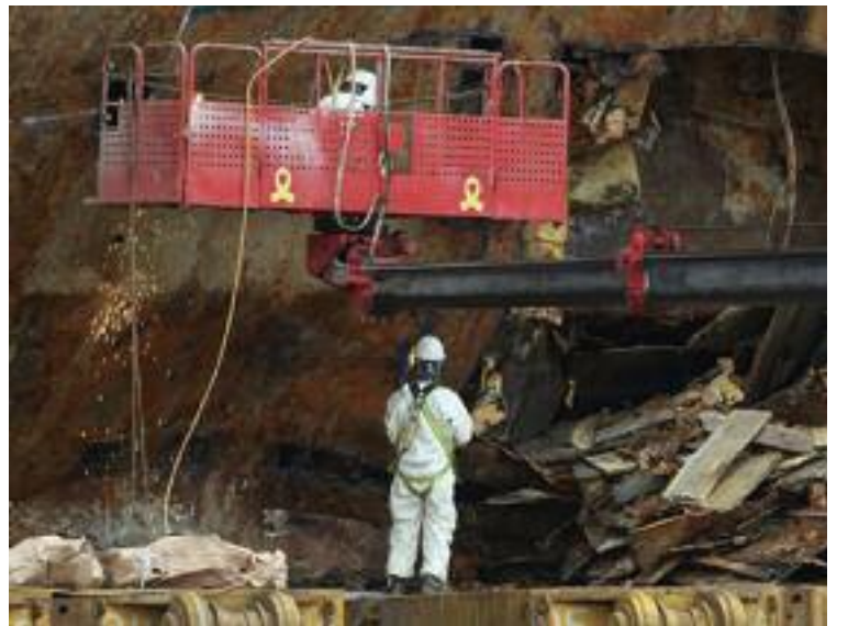
세월호 선내수색 중 사람의 것으로 추정되는 뼈가 발견된 10일 오후 세월호가 거치된 목포신항에서 코리아셀베지 소속 작업자들이 추가 진입로 확보를 위한 작업을 하고 있다
