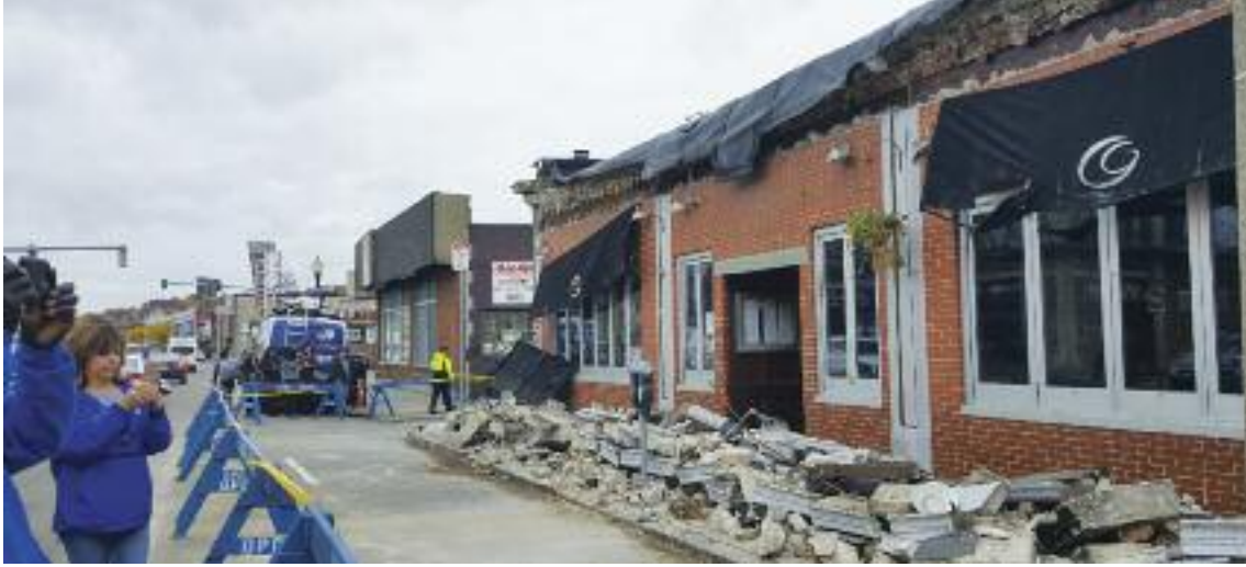
하버드에비뉴 소재 김치파피스 키친 건물의 입구 장식부분이 무너져 내린 모습. 4일 새벽 일어난 이 사고로 해당 건물 내 각종 비즈니스업체의 영업이 중단됐다
